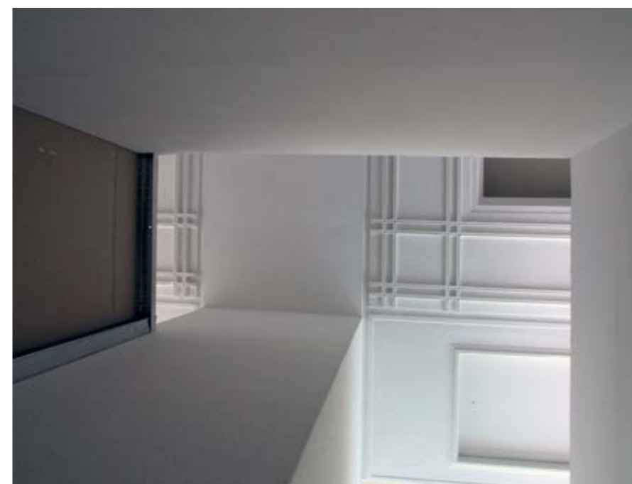
Um zwei Säulen des Ausstellungsraumes wird ein Gang aus Rigipswänden gebaut, dessen Eingang einem Portal ähnelt. Der Gang führt in eine Sackgasse, in der sein Inneres auf seine Außenwand trifft.
